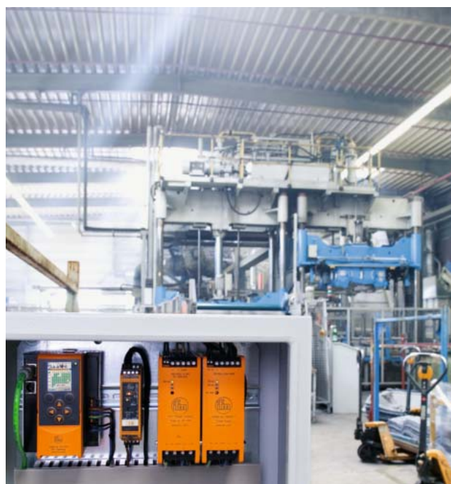
Pasarela AS-i en un armario eléctrico descentralizado
