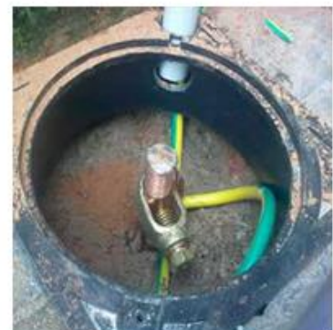
Interruptor Diferencial + Puesta a Tierra
