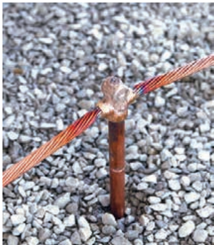
Los sistemas de conexión a tierra de los edificios a veces pueden identificarse por la presencia de cable de cobre desnudo trenzado conectado a varillas de tierra.
