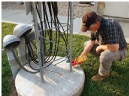
Los sistemas de electrodo de tierra deben probarse en forma rutinaria con medidores de resistencia de puesta a tierra para verificar que la resistencia es lo suficientemente baja como para proporcionar protección adecuada al equipo y al personal.
